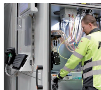
Reparaciones (en sitio y centro de servicios ABB)
