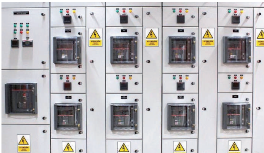
Vista Mecánica del Cuadro Electrico de Baja Tension
